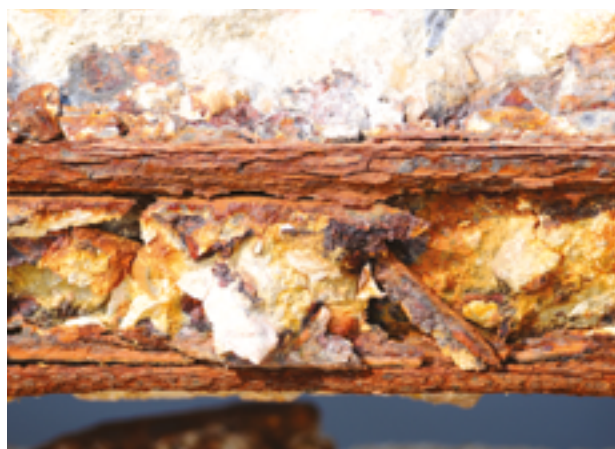
Exemple de dégradation du béton par corrosion des fers d'armature.
