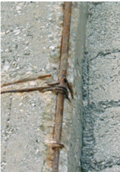
Dégradation de l'enrobage dans un pilier en béton.
