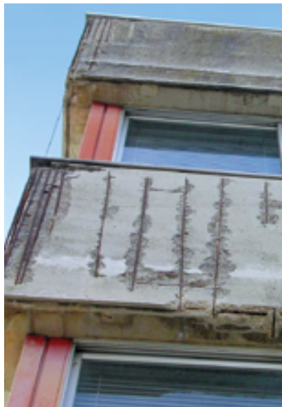
Béton avec armatures mise à nues suite à la dégradation.
