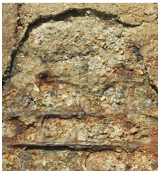
Exemple de corrosion due à l'attaque de chlorures.
