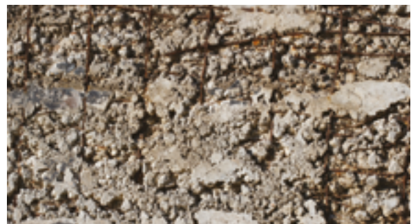
Exemple de séparation des agrégats du béton.
