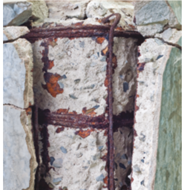
Expulsion de l'enrobage par corrosion des fers d'armature.
